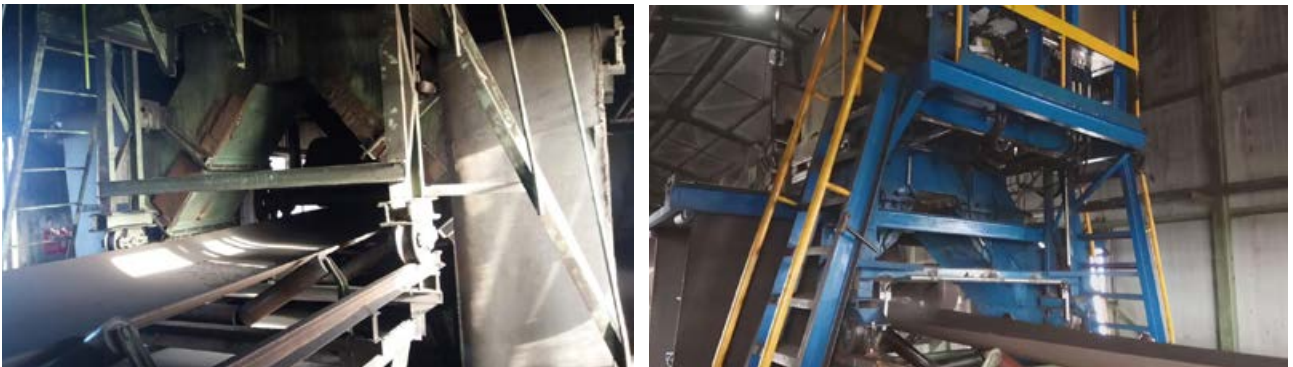
图 4 改造前、后的皮带布料小车现场对比图
