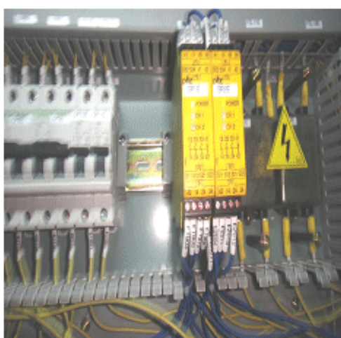
图 8 安全继电器在称重控制柜中
